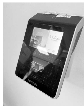
HR入口にある顔認証システム
